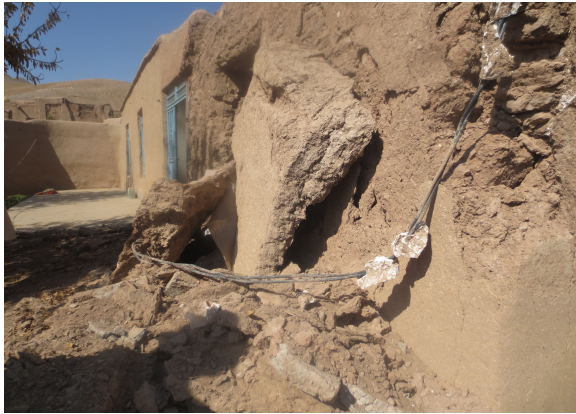
تصویر دیگری از تخریبات زلزله در قریه خواجه قاسم ولسوالی کشک رباط سنگی ولایت هرات.
