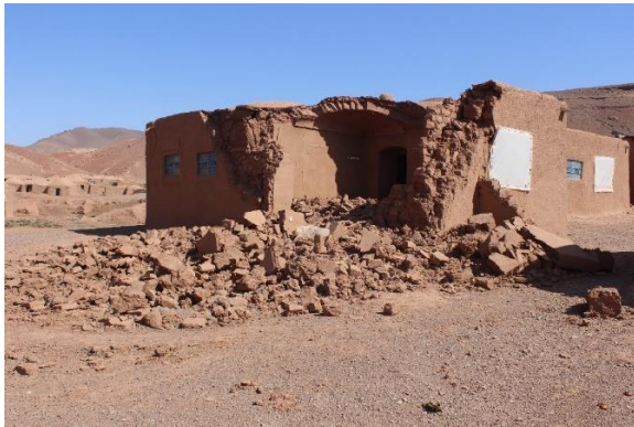
قسمت تخریب شده یک خانه مسکونی در قریه خواجه محمد شورآب ولسوالی گلران.
